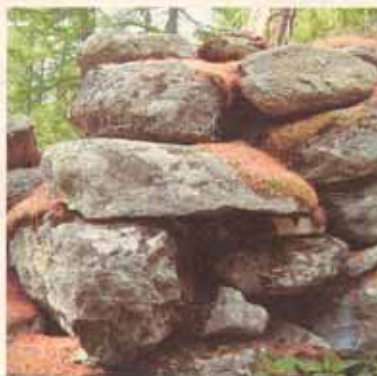
Das alte, vom Zerfall bedrohte Mauerwerk.
